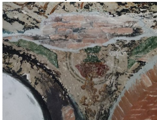
Рис.8. Фрагмент стіни після пожежі. Фото ст. Д. Дружиніної, 2024
