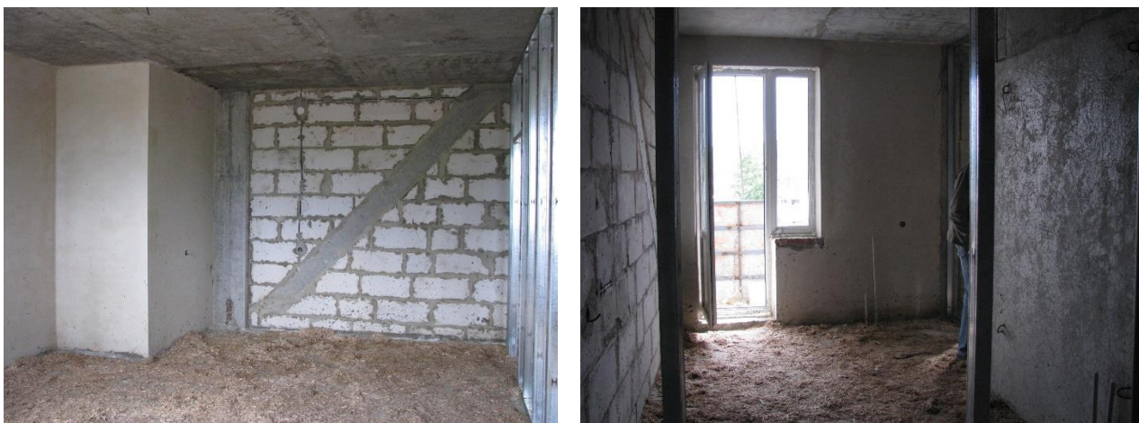
Рис. 12 Фотофіксація готовності квартири за адресою: бульвар Богдана Хмельницького, 21 Полтава. 2008 рік. Ліворуч загальна кімната, праворуч – кухня з виходом на балкон (з архіву автора Зосіма С.А.)
