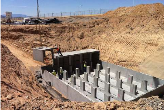
Рис.2. Підземний резервуар дощової води. Джерело: [13].
