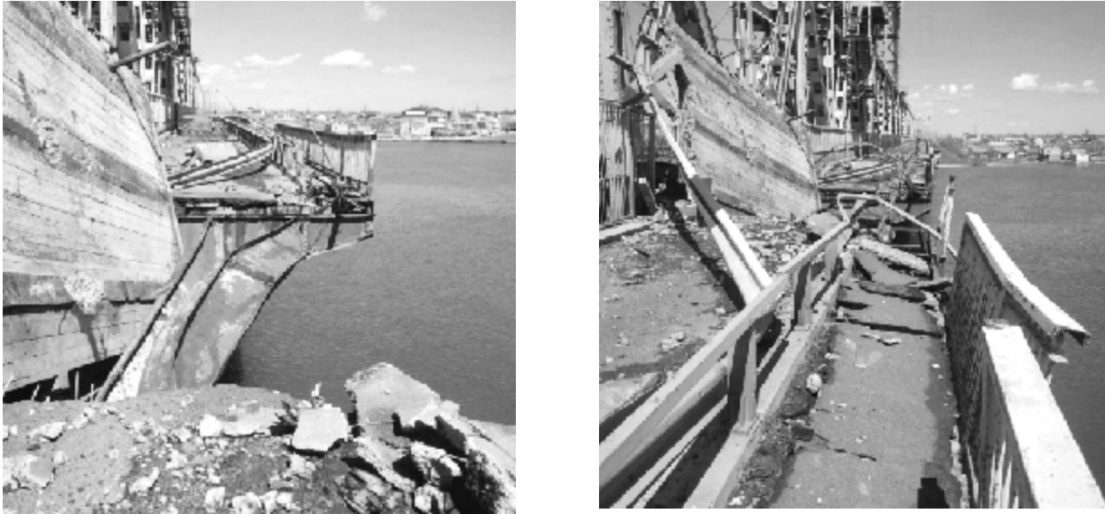
Рис. 5. Ушкодження залізнично-автомобільного мосту у Затоці, Одеська область (26.04.2022)
