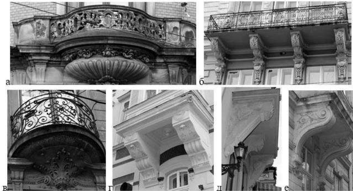
Рис. 4. Балкони за формою балконної плити та оздобленням огороження бувають: а) криволінійні, огороження муроване (пр. Свободи, 15); б) прямокутні, огороження оздоблене завитками, кругами, кронштейни – масками левів, картушами та ін. (пр. Шевченка, 34); в) півкруглі, огороження оздоблено завитками, квітами та ін. (вул. Ген. Чупринки, 7); г) кронштейни оздоблені акантовим листям та гутами (вул. Лук'яновича, 9-11); д) кронштейни оздоблені щитами та пальметами (пл. Маланюка, 7); е) кронштейни оздоблені волютами (вул. Рилєєва, 9).
